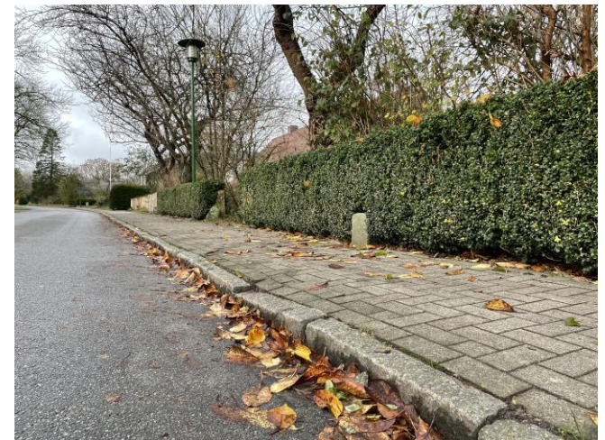
Abbildung 5: Gehwegschäden in Vollstedt (eigene Abbildung)
